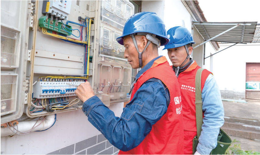
合肥巢湖市供电公司党员服务队队员在姥山岛开展低压设备检查
