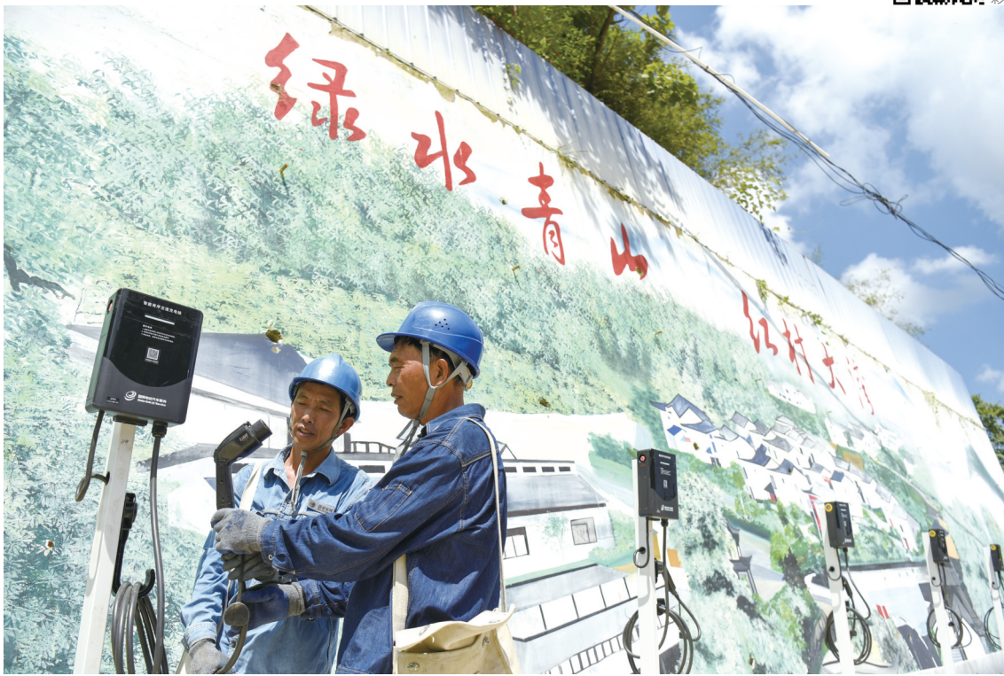
8月4日,六安市金寨县花石乡大湾村,国网金寨县供电公司的技术人员在对充电桩进行巡检
