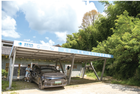
位于金寨县花石乡大湾村的光伏、充电一体化5G智能充电站
