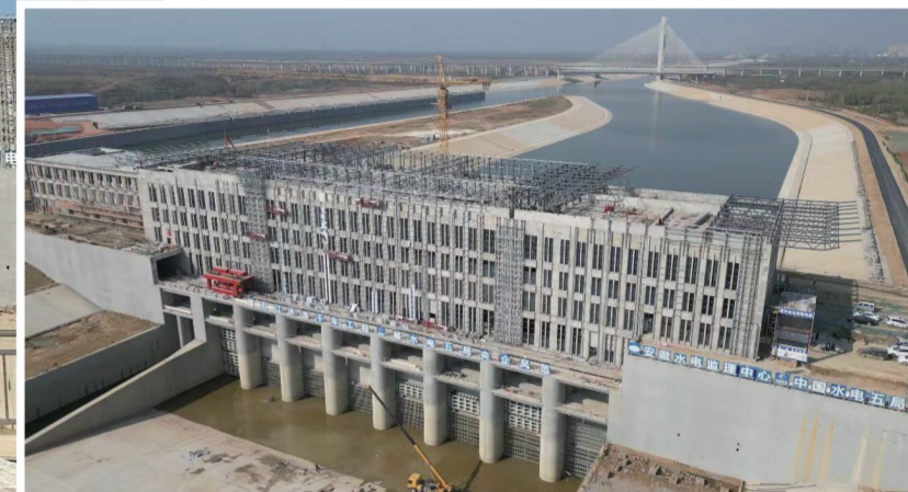
引江济淮工程蜀山泵站
