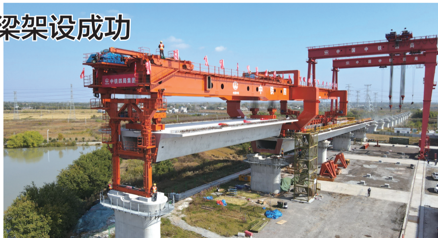
这是中铁四局合新铁路安徽段站前七标箱梁架设现场。(10月30日摄,无人机照片)
