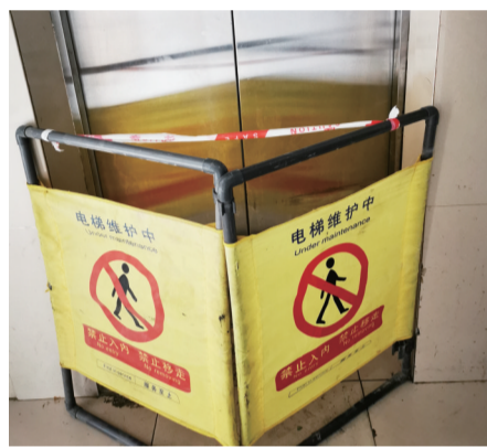
出事的电梯正在维修
