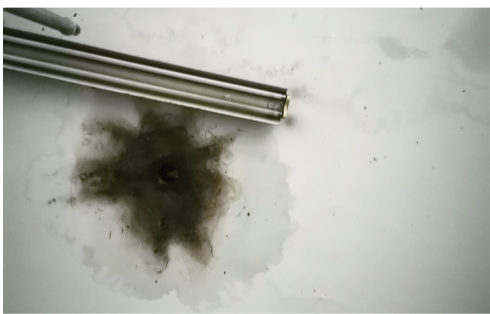
天花板上的渗漏点
