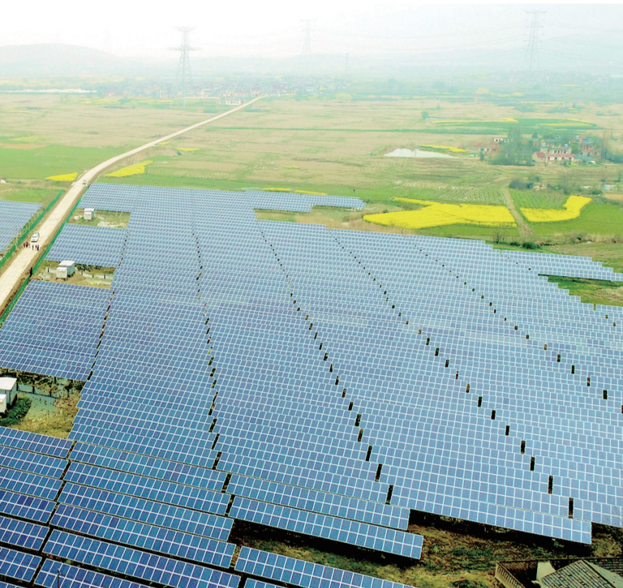
合肥地区首个地方光伏扶贫电站——巢湖坝镇石塘村集体电站航拍 李岩/摄
