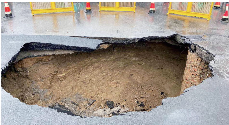
7月19日9点30分左右，合肥市庐阳区大杨镇城管队员在清源路与腊花路交口发现一处路面塌陷。截至记者发稿前，已经抢修完毕。 口记者 于彩丽
